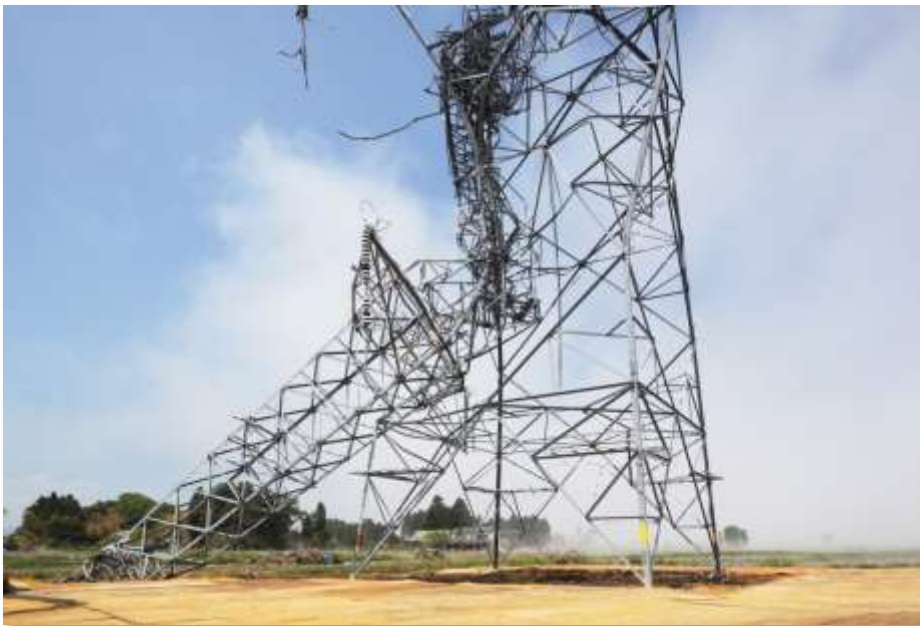
地震か津波で破壊された南相馬の鉄塔 写真提供：齋藤さだむ
